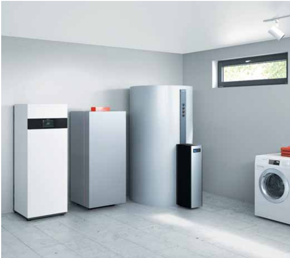
Brennstoffzelle Vitotalor PA2 nachgerüstet in einer Anlage mit Gas-Brennwertkessel Vitocrossal 300 und Heizwasser-Pufferspeicher Vitocell
